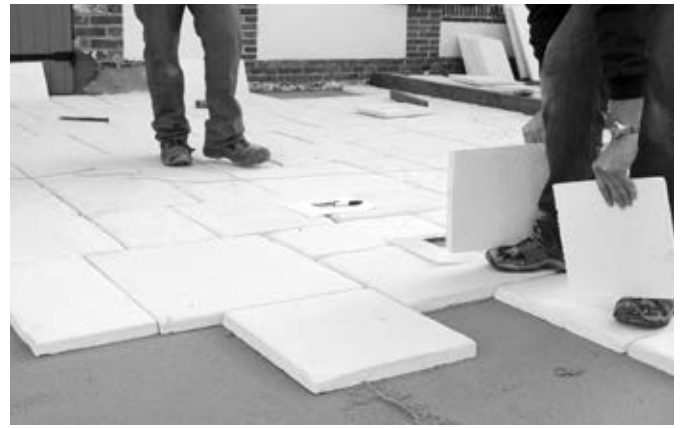
Mise en place des dallages (ici des dalles Castellane en opus multiformat) sur lit de sable parfaitement de niveau.
